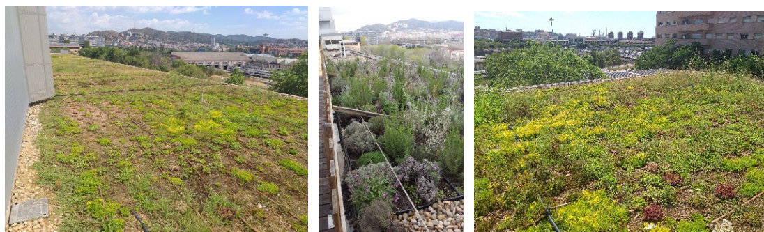
Figura 5. Cobertes verdes extensives i semi-intensives a l'edifici TEBVerd
